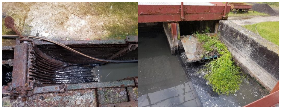
Krata łukowa przepompowni
