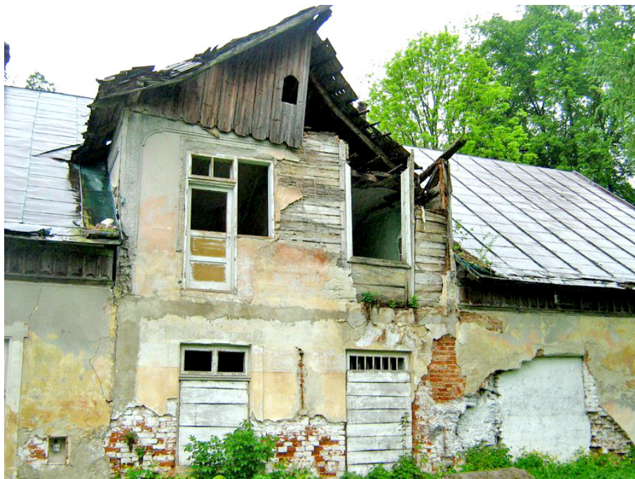
Zdjęcie nr 13 Zniszczony budynek dworu w Falejówce
