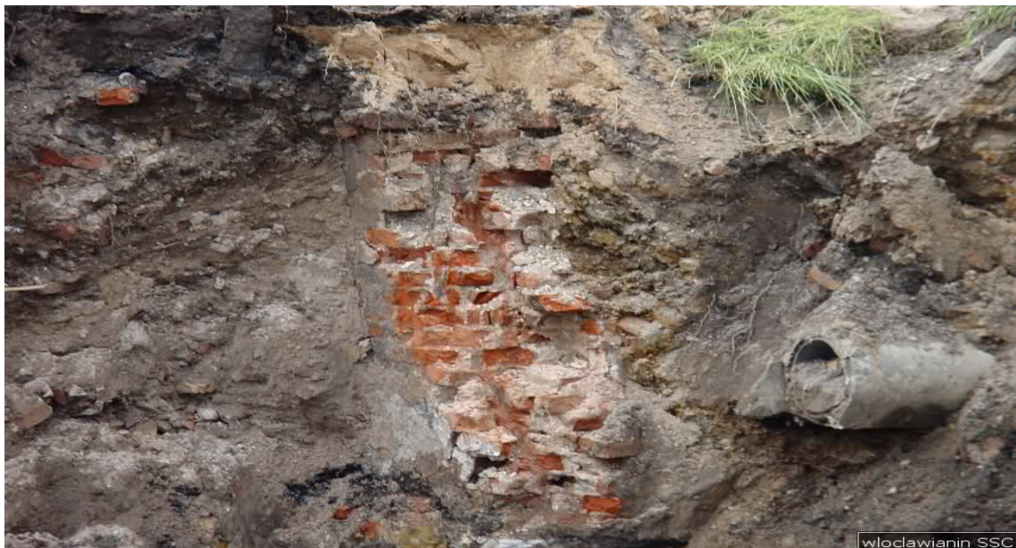
Włocławek ul. Okrzei okolice ronda biskupa Kozala. Nieprzewidziane w projekcie pozostałości budynków.
