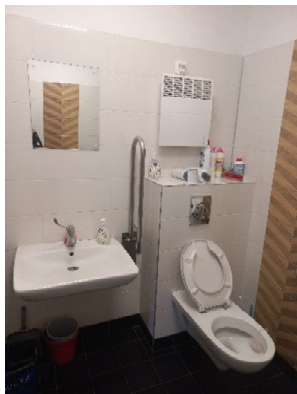
Zdjęcie nr 7 ZPiSdN w Konstancynie Łódzkim – pomieszczenia sanitarno-higieniczne przy izbach adaptacyjnych i izolacyjnych
